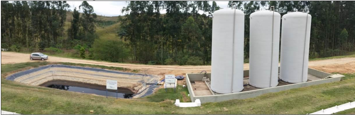
Figura 44: Armazenamento temporário do chorume.
